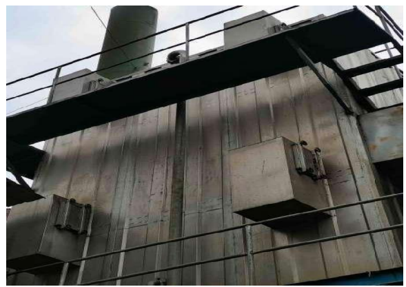
车间废气处理设施
