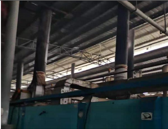
本项目车间废气收集管道
