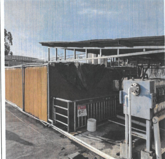
项目污水处理站
