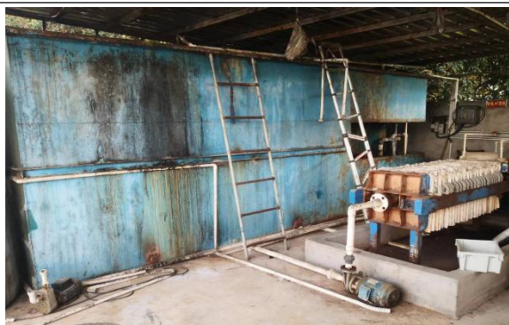
项目废水处理设施
