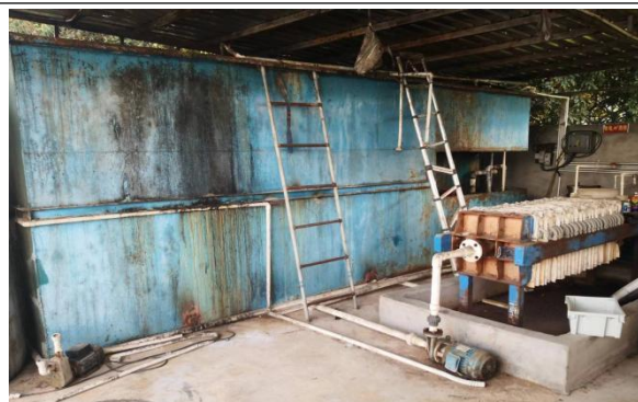
项目废水处理设施
