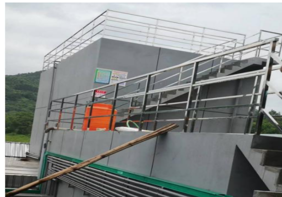
项目废水处理设施
