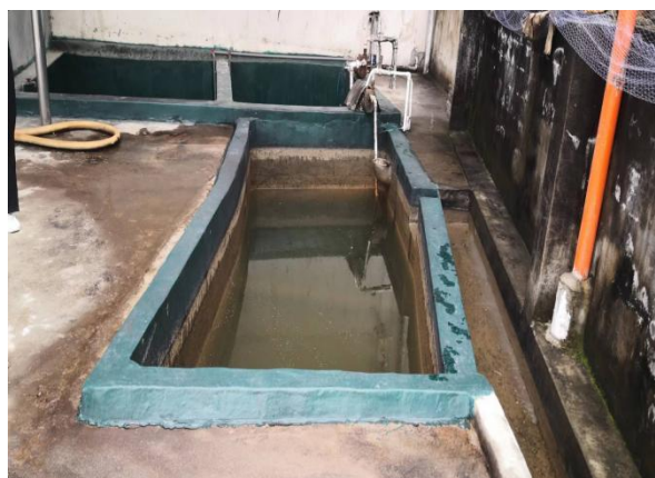
项目废水收集池
