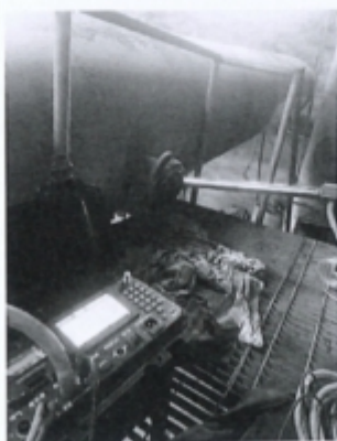
锅炉废气处理后检测口/Q1
