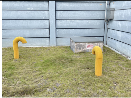
现有事故油池
