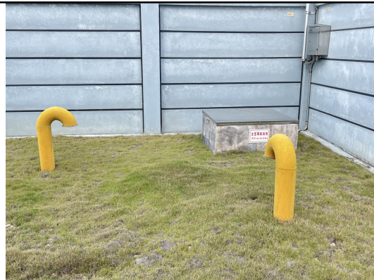
现有事故油池
