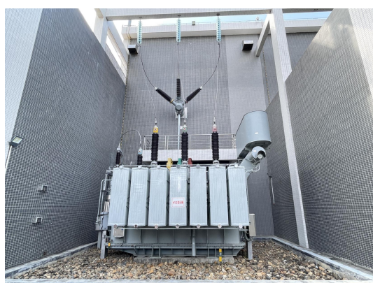
现有#1 主变位置
