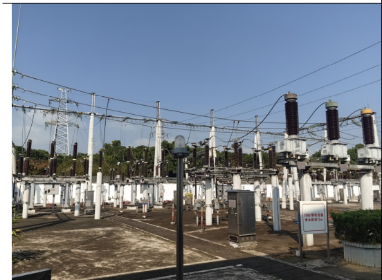
110kV 配电装置区
