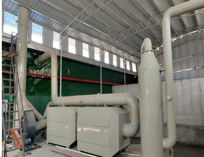
碱液喷淋+二级活性炭吸附装置
