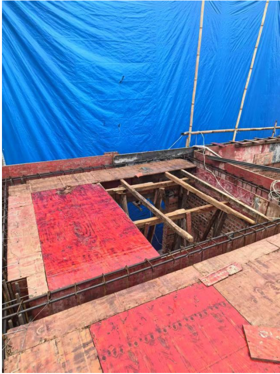
图 1：事故楼顶现场照片
