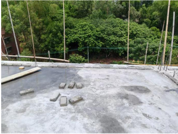
图 1：事故楼顶现场照片
