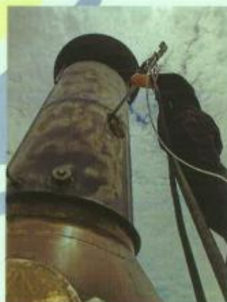
工艺废气排放口 DA004
