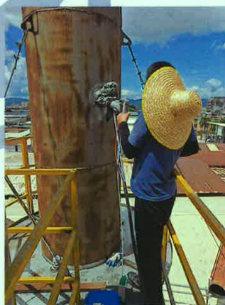
DA003 2#定型废气排放口
