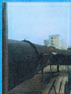
定型废气处理前采样口 DA003
