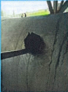
定型废气处理前采样口 DA002
