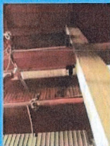
天然气锅炉废气采样口 DA004
