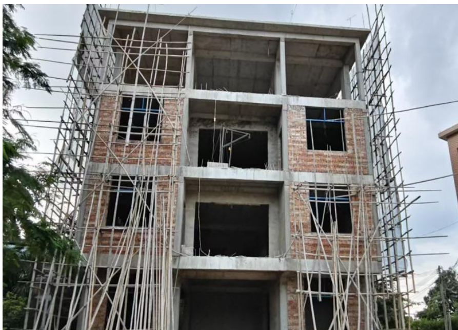
图 1 事故自建住宅照片
