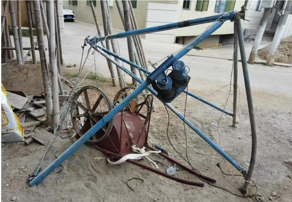
图 2 事故自建住宅地面的简易吊机和斗车
