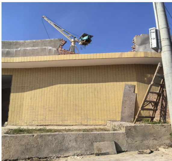
图 1 事故楼房 1 层照片
