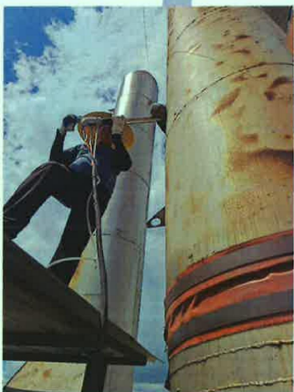
DA002 1#定型废气排放口
