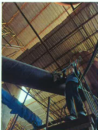
DA004 锅炉废气排放口
