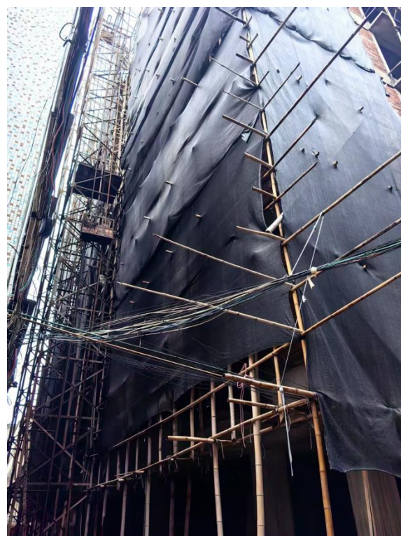
图 2 事故楼房外围照片
