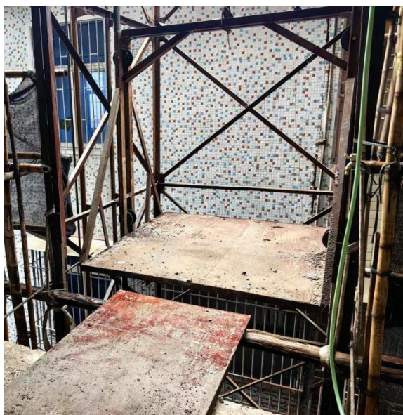
图 1 事故升降机平台照片
