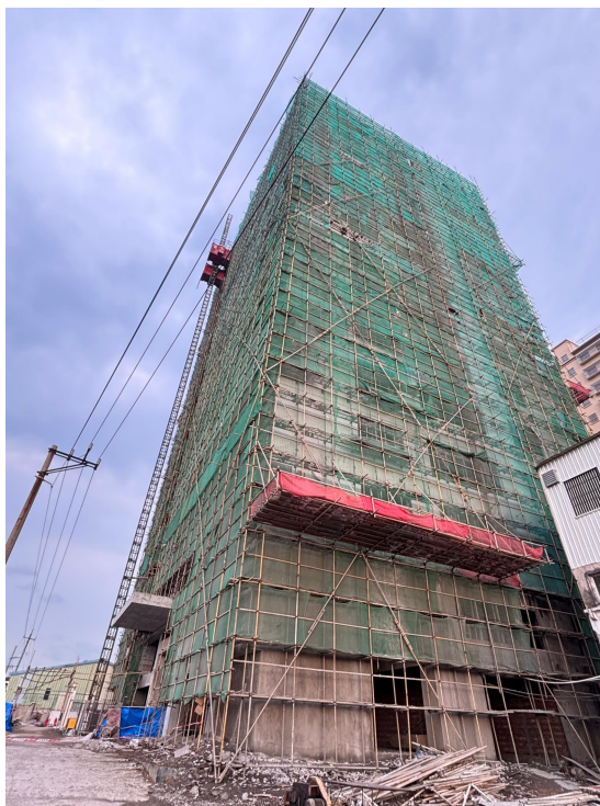
图 1 事故现场照片
