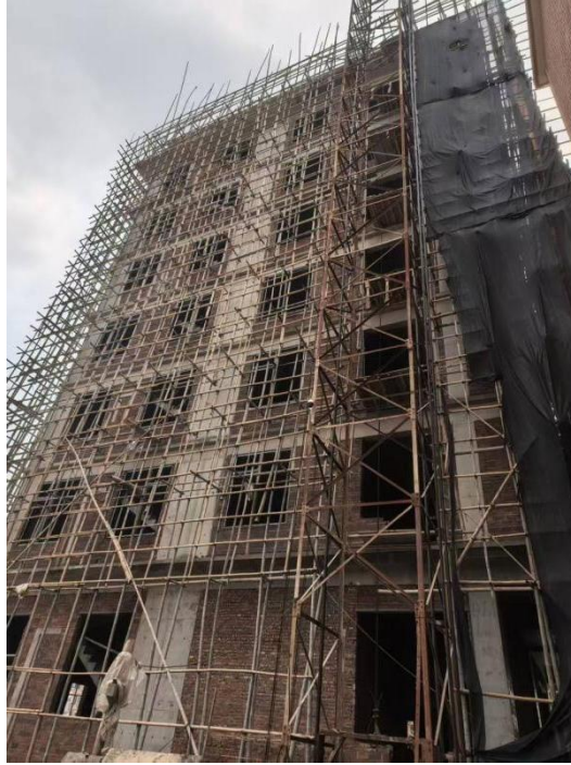
图 1 事故现场照片
