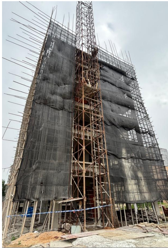
图 1 事故现场照片
