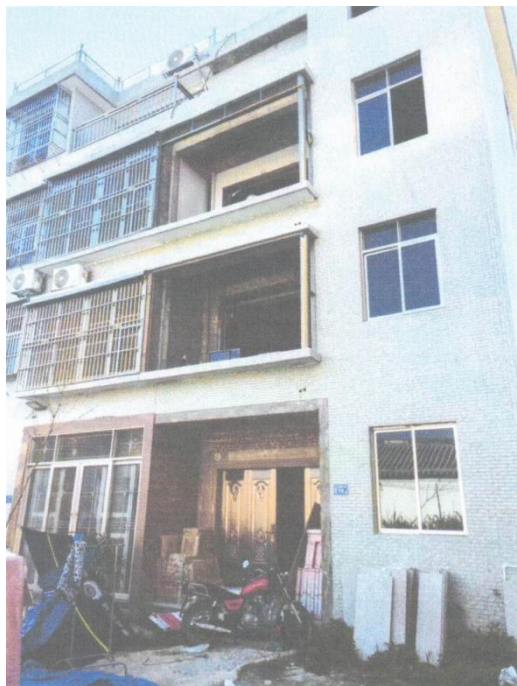
图 1 事故现场照片
