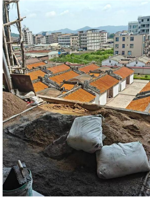
图 2 现场五层阳台情况
