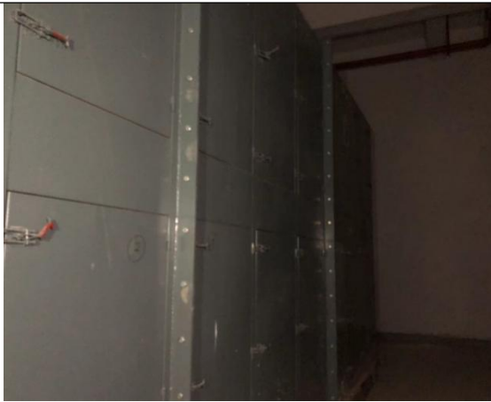
停炉废气处理-活性炭吸附箱
