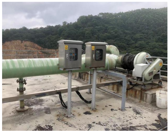
臭气密闭收集装置
