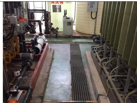
高浓度污水处理设施应急收集槽
