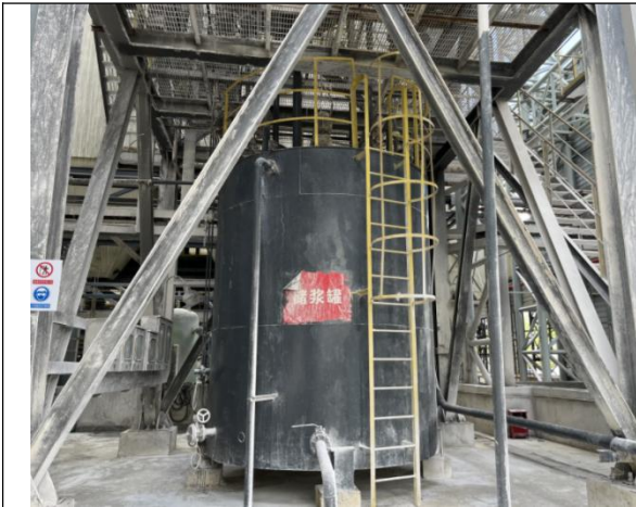
石灰浆制备间
