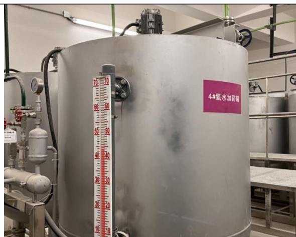
化水间氨水罐
