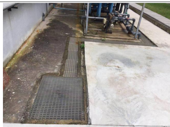
低浓度污水处理设施应急收集槽
