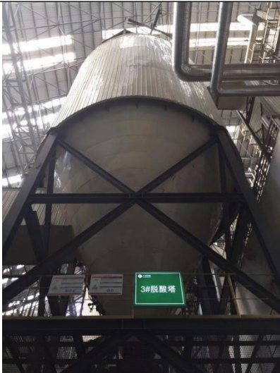
焚烧炉烟气处理-脱酸塔
