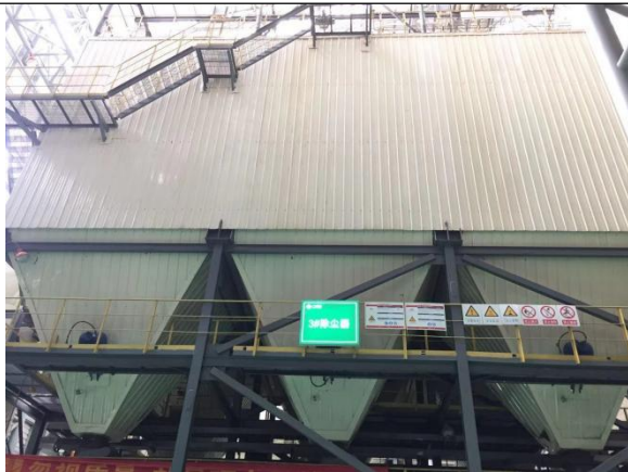
焚烧炉烟气处理-布袋除尘器
