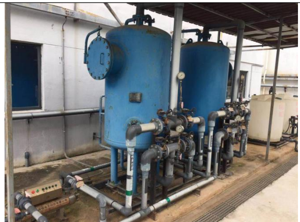
活性炭过滤器
