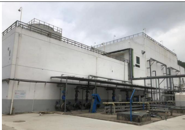
高浓度污水（垃圾渗滤液）处理系统
