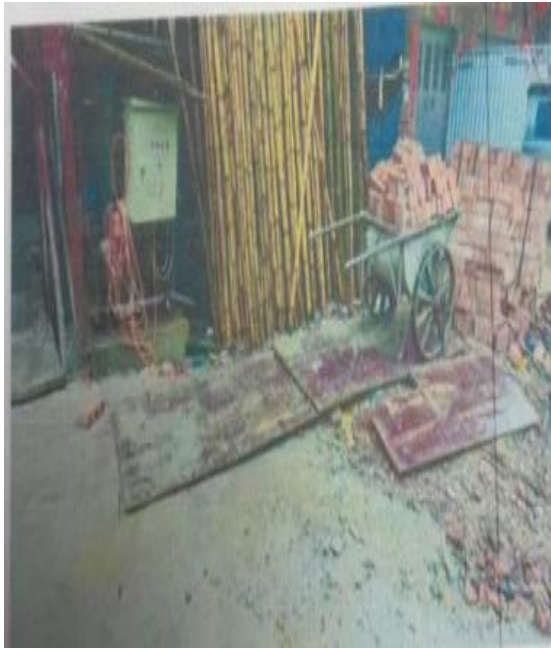
图 1 事故现场照片
