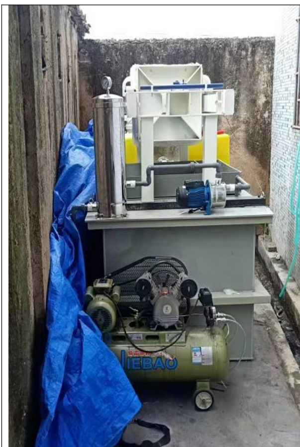
污水处理设施
