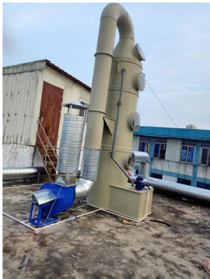
废气处理设施
