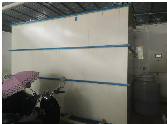
废水处理设施
